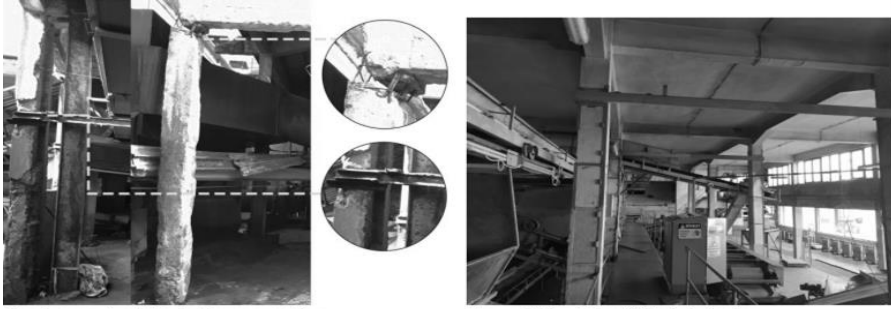
Bazı hasar görmüş kolonların ayrıntıları
